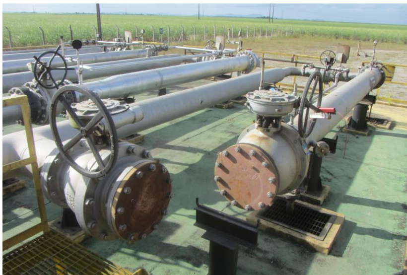
Figura 10 - Trecho lançador de pig desconectado e isolado Fonte: Própria (2022)
