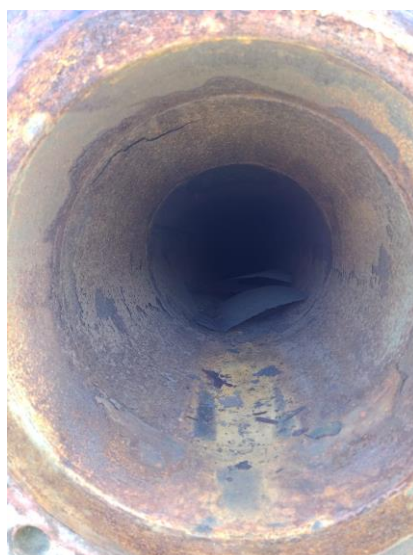
Figura 15 – Descolamento da camada interna do duto Fonte: Própria (2022)
