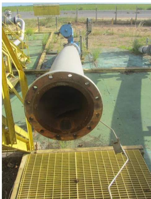
Figura 11 – Início do duto na estação emissora Fonte: Própria (2022)
