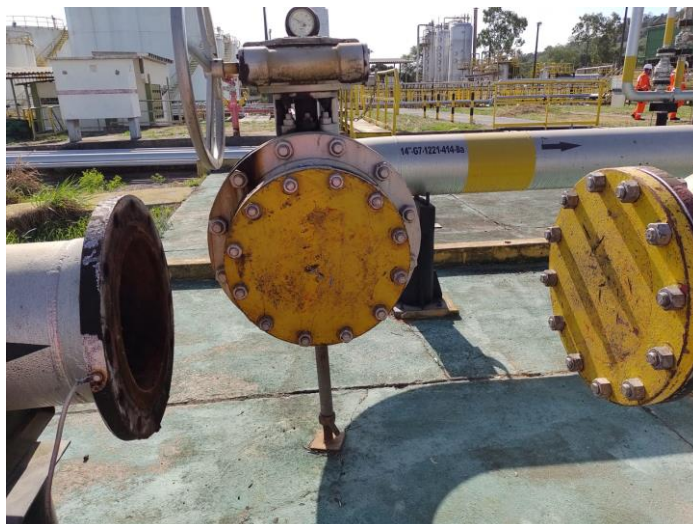
Figura 12 – Trecho receptor de pig desconectado e isolado Fonte: Própria (2022)
