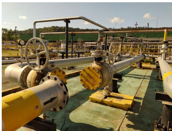
Figura 13 – Arranjo espacial da chegada do duto na estação recebedora Fonte: Própria (2022)
